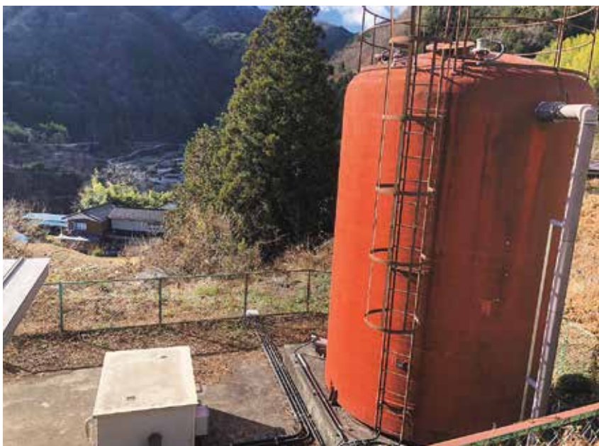
かじかの湯源泉ポンプ
